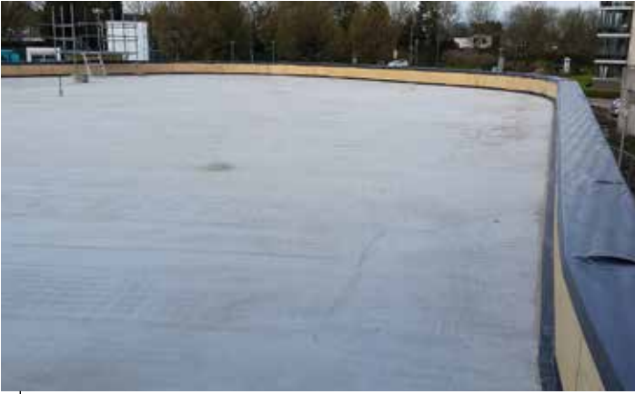
De betonnen onderconstructie ligt niet of nauwelijks op afschot.
